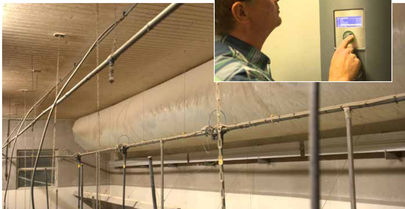
Control de la temperatura en la granja de Timo Heikkilä, Finlandia
